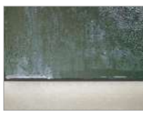
全面に大粒な結露が発生
